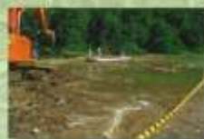
ダム貯水池の河床堆積
